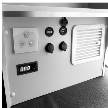
運転席側キャビネット（電装部）
